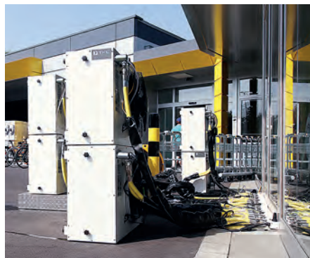
Die mittels PlanoPT unterführten Türen können verschlossen bleiben, sodass die Verbindungen zum Nachtabschluss nicht demontiert werden müssen und die Klimageräte bei Bedarf rund um die Uhr in Betrieb bleiben können.
